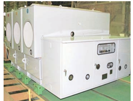
発電機主回路遮断器(GMCB) *2
